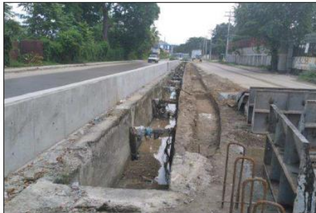
Media barrera paralela a canal de agua lluvia existente.
