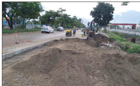
Terracería al final del ramal 2da calle-centro de SPS.
