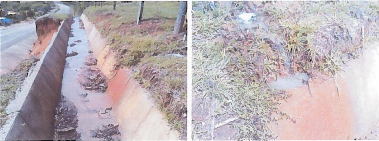
Vista de la escorrentía que fluía bajo la contracuneta, imposibilitando el inicio de la construcción del muro de mampostería.
