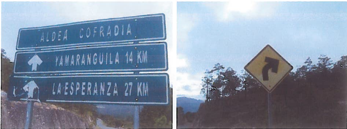
Vista de algunas señales que deben ser reemplazadas debido a su deterioro.
