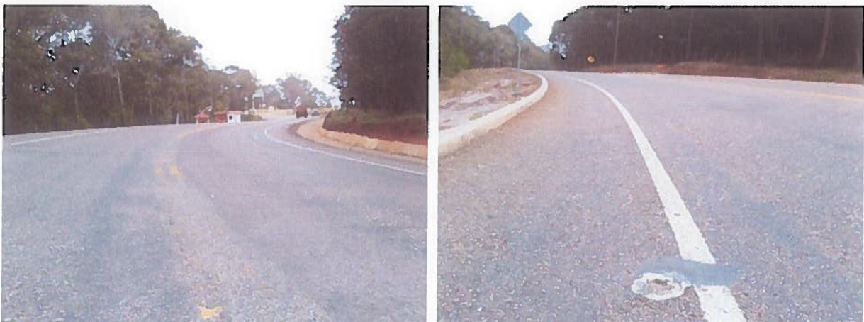
Vista de algunos sectores donde se requiere reposición de señalización horizontal.
