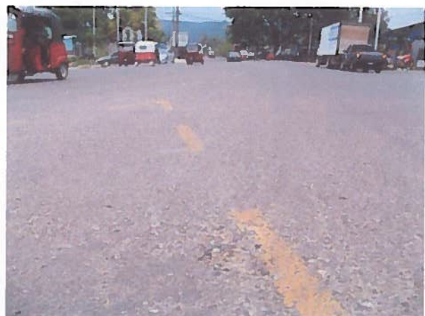
Vista de la condición actual, la pintura no ha sido restablecida.
