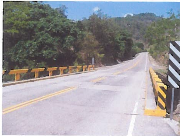
Vista de los sellos superficiales colocados en el puente Higuito, según requerimientos de la SAPP.
