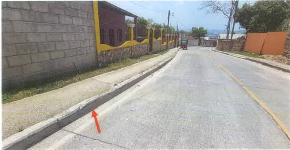
Toma de la Acera y Bordillo Continuo en el Km 1+170 L. D. Se puede observar que se mantienen en buen estado, limpia y completos.
