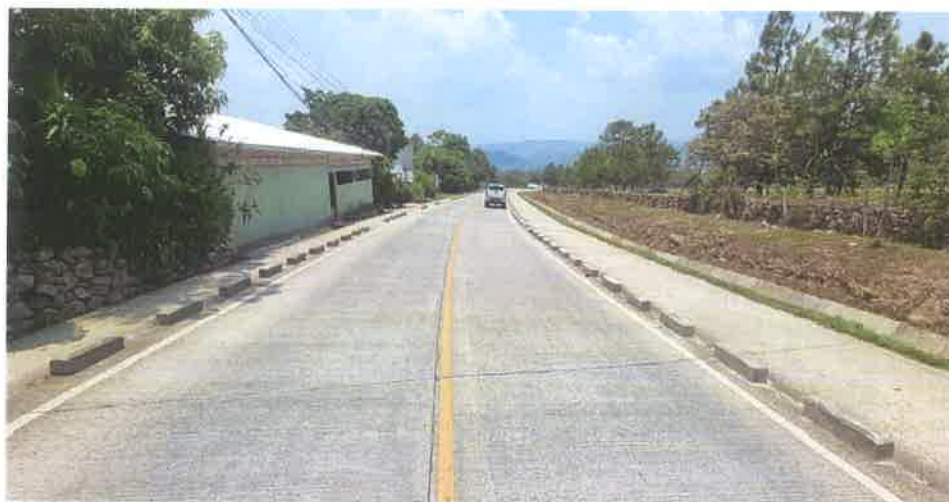
Imagen de la Pintura Termoplastica del Km 2+138 donde se puede observar que la de la línea central aun se mantiene en buen estado.
