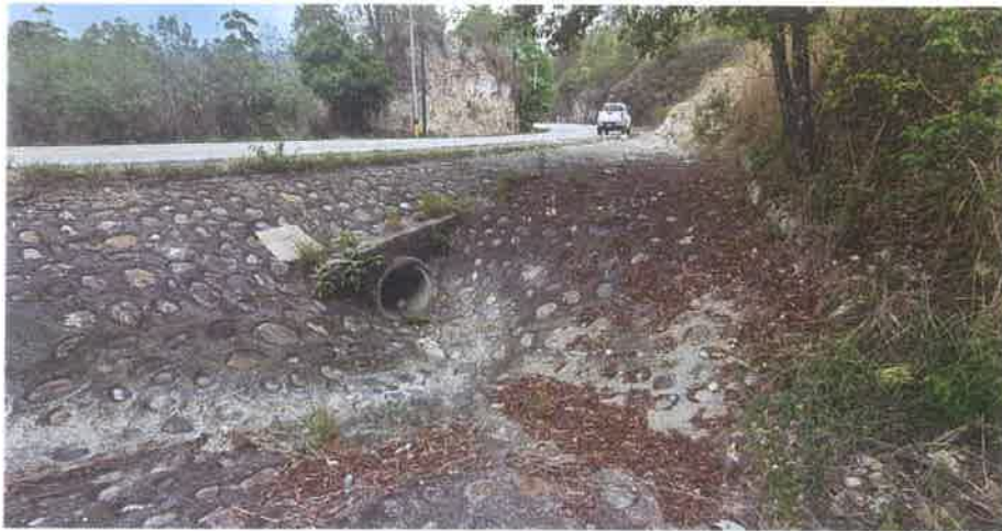
Toma de la Alcantarilla Transversal del Km 74+180 donde se puede observar su salida completamente limpia.
