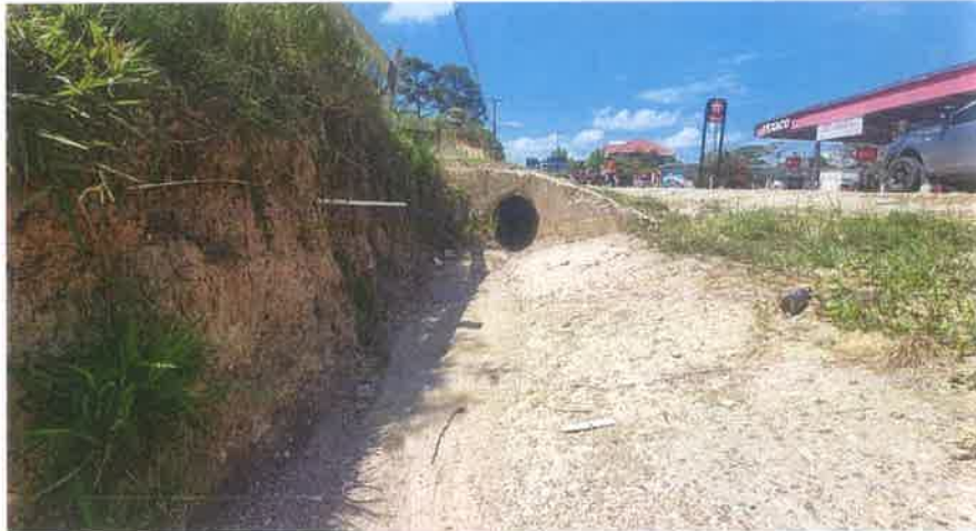
Imagen en el Acceso Lateral en el Km 48+800 L. D. donde se puede observar la tubería que esta limpia tanto en su salida como su interior.
