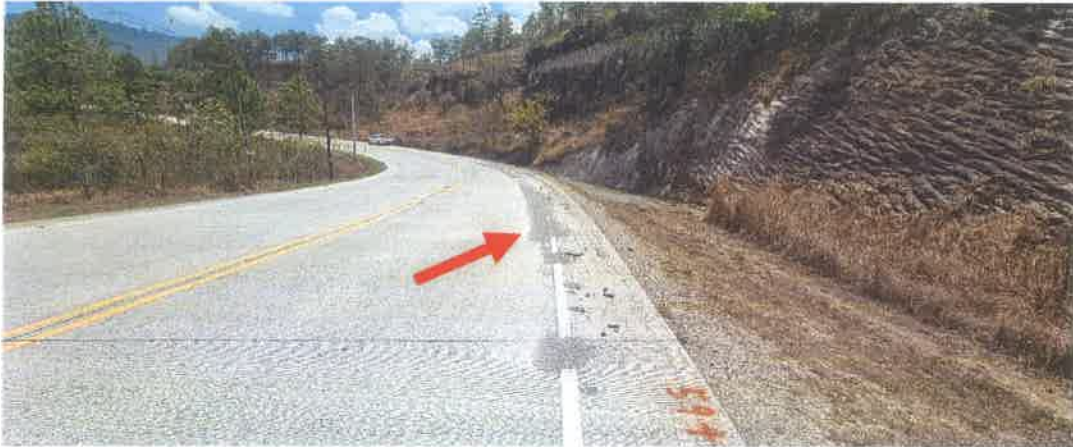
Calzada de Rodadura contaminada en Km 76+630 – 76+670 L. I.
