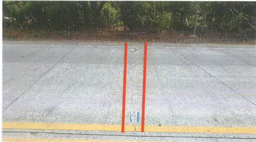
Sellar Grieta en el Km 68+128 L. D.
