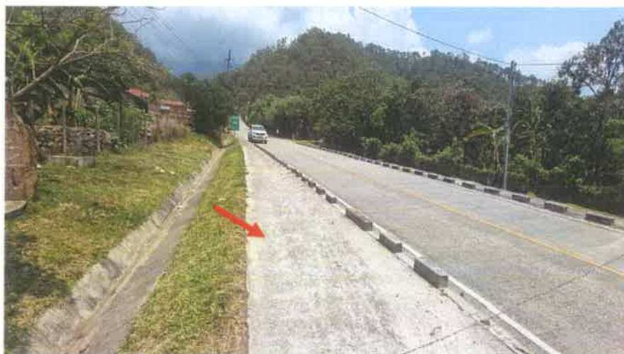
Toma del tramo de Ciclovía en el Km 5+285. Se puede constatar que la Ciclovía se mantienen en buen estado.
