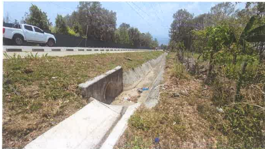
Toma de la salida de la Alcantarilla Transversal doble del Km 2+965. Se puede observar que sus interiores están completamente limpios.
