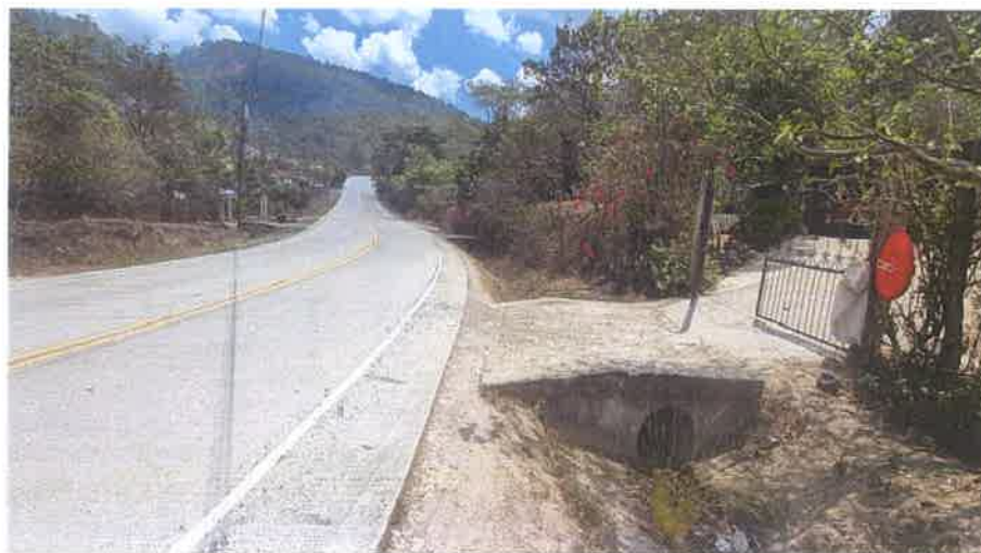
Toma del Acceso lateral sin Pavimento del km 60+230 L. D., observese que aún se mantiene sin producirse grada entre la losa y la cuña de B-C.
