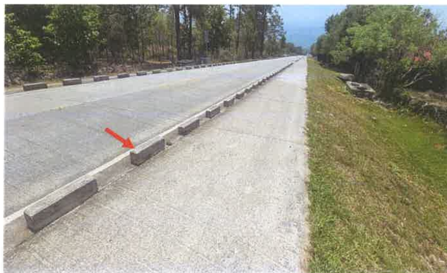
Toma de la Acera y Bordillo Intermitente en el Km 4+112 L. I., observese que ambos se mantienen en buen estado.
