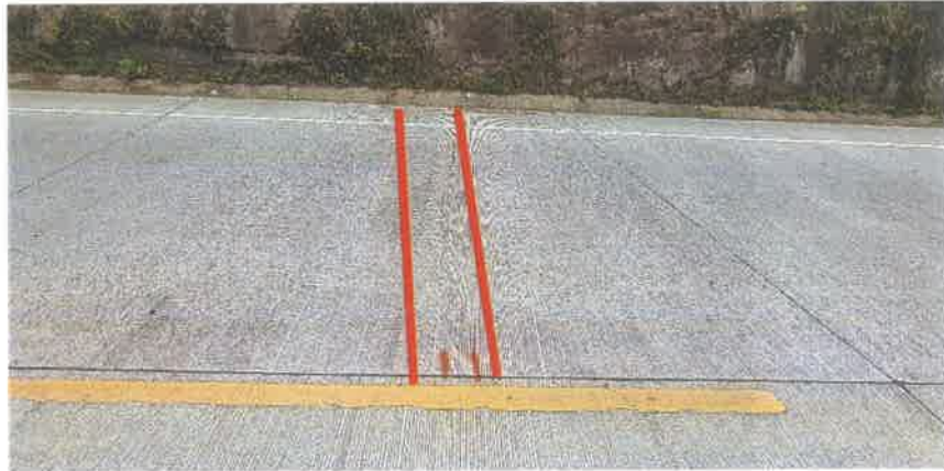
Sellar Grieta en tramo del Km 63+874 – 63+879 L. I.
