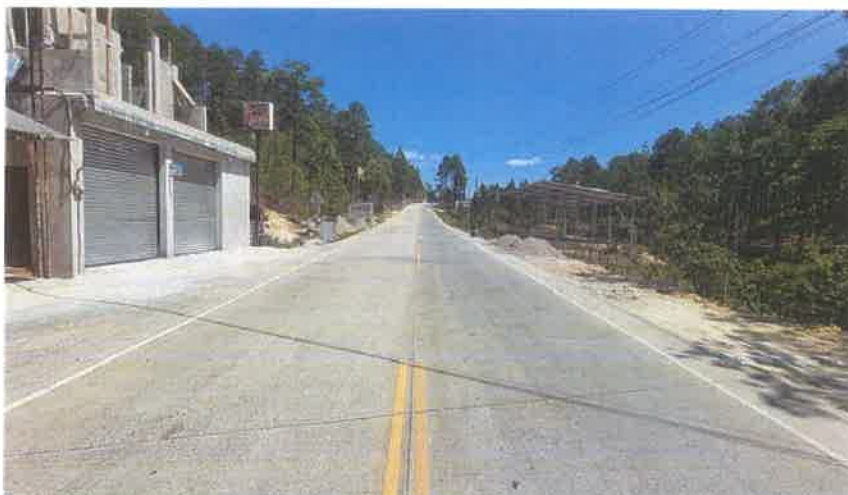
Toma de la Pintura Termoplastica colocada en el Km 49+36 en linea central, donde se puede observar que en este tramo aun está en buen estado.
