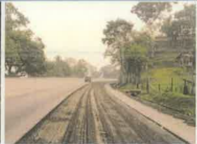
Foto 3. Taulabé – Desvió Santa Cruz de Yojoa Fresado capa superior de carpeta asfáltica dañada, espesor 5 cm
