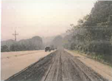
Foto 1. Taulabé – Desvió Santa Cruz de Yojoa Fresado capa superior de carpeta asfáltica dañada, espesor 5 cm.
