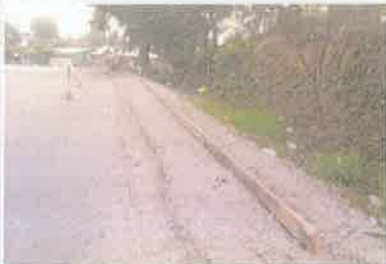
Foto 4. Conformación de área e inicio de encofrado para construcción de acera peatonal.
