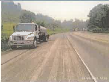
Foto 1. Taulabé – Desvió Santa Cruz de Yojoa Fresado capa superior de carpeta asfáltica dañada, espesor 5 cm
