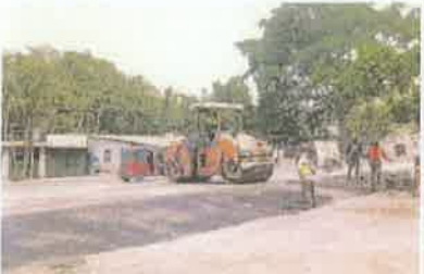
Foto 4. Vista de los trabajos en la construcción de acceso en el proyecto
