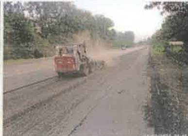
Foto 2. Taulabé – Desvió Santa Cruz de Yojoa Fresado capa superior de carpeta asfáltica dañada, espesor 5 cm.
