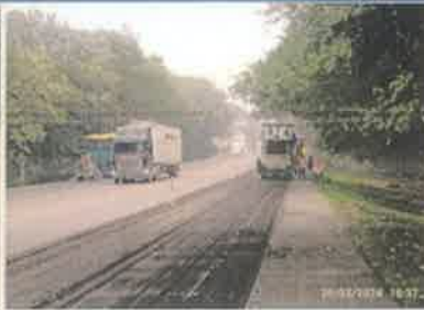
Foto 2. Taulabé – Desvió Santa Cruz de Yojoa Fresado capa superior de carpeta asfáltica dañada, espesor 5 cm
