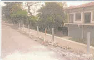
Foto 1. Vista de la colocación de postes metálicos contiguo a corona de muro construido
