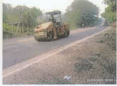
Foto 6. Taulabé – Desvió Santa Cruz de Yojoa Compactación franja de mezcla asfáltica, espesor 5 cm.
