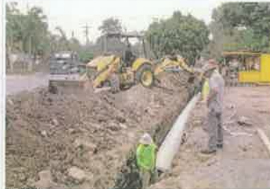
Foto 5. Colocación de tubos de PVC 24 pulgadas para drenar agua que se estancaba en rotonda.
