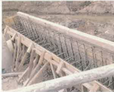
Foto 1. Vista del acero de refuerzo colocado según especificaciones en corona de estribo.
