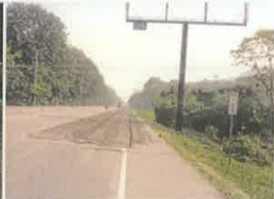
Foto 3. Taulabé – Desvió Santa Cruz de Yojoa Fresado capa superior de carpeta asfáltica dañada, espesor 5 cm.
