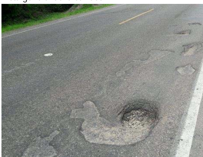
Numerosos baches, con profundidades considerables.
